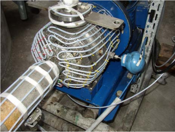
Pumpenheizung mit Drahtkorb
